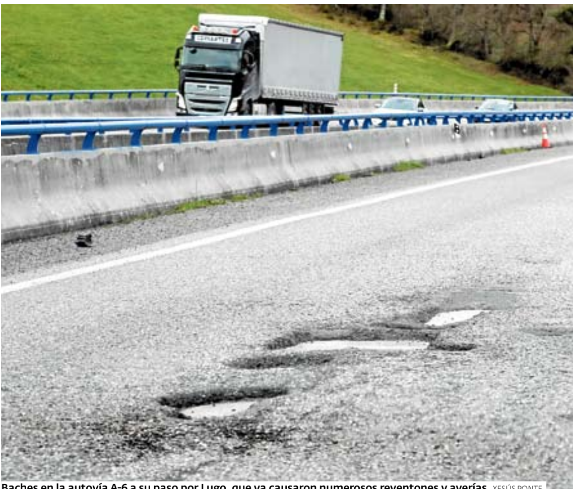
Baches en la autovía A-6 a su paso por Lugo, que ya causaron numerosos reventones y averías. XESÚS PONTE
